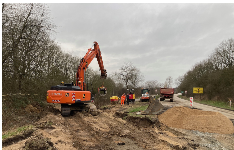
Oben rechts: Provisorisch gesperrter Warnauer Weg - die Sperrbake wurde schon zerstört!
